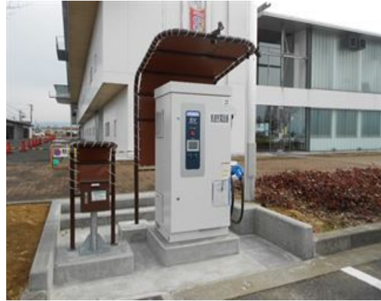
急速充電器（北会津支所）
