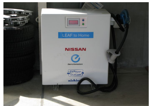
電気自動車から建物に給電もできるV2H
