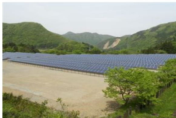
名称 大戸町第1・第2発電所 所在地 大戸町舟子 事業者 SEエナジー株式会社 設備容量 約2,400kW (約1,200kW×2箇所)
