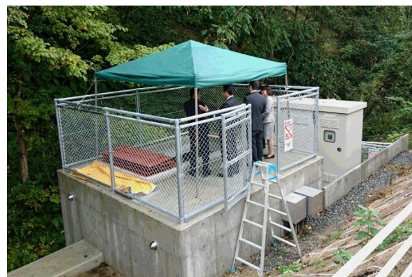
名称 会津電力戸ノ口堰小水力発電所 所在地 一箕町八幡 事業者 会津電力株式会社 設備容量 31.4kW
