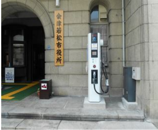
急速充電器（本庁舎）
