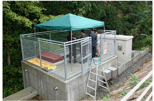
名称 会津電力戸ノ口堰小水力発電所 所在地 一箕町八幡 事業者 会津電力株式会社 設備容量 31.4kW
