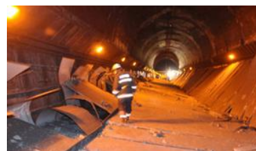
写真：笹子トンネル天井崩落事故 (2012年12月2日 山梨県大月市)
