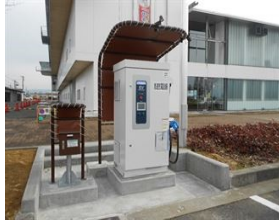
急速充電器（北会津支所）
