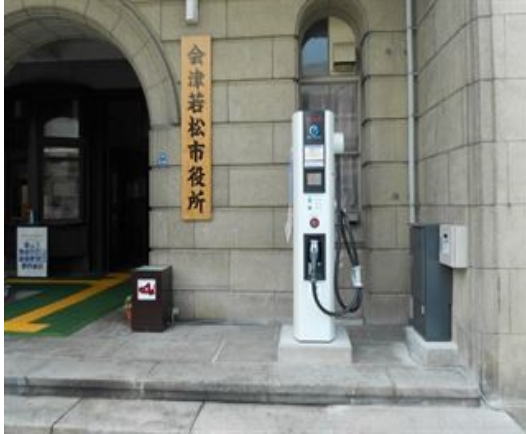
急速充電器（本庁舎）
