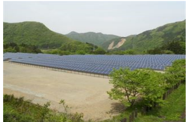
名称 大戸町第1・第2発電所 所在地 大戸町舟子 事業者 S E エナジー株式会社 設備容量 約2,400kW (約1,200kW×2箇所)
