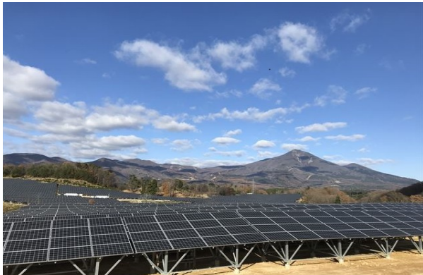
名称 ナリ会津太陽光発電所 所在地 河東町八田 事業者 会津ソーラーエネルギー合同会社 設備容量 20,400kW
