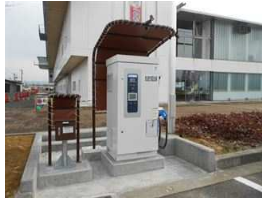
急速充電器(北会津支所)
