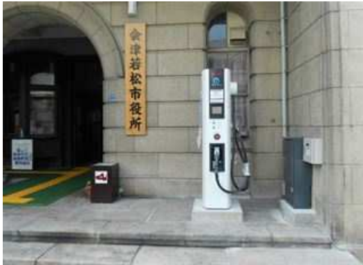
急速充電器(本庁舎)
