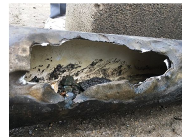
写真1 老朽化による配水管の漏水跡
