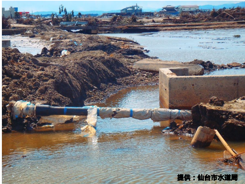
写真5 災害に強い管路の実現（津波で流されなかった耐震管）
