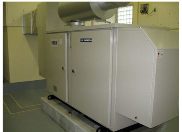
写真8 下雨屋ポンプ場の自家発電設備
