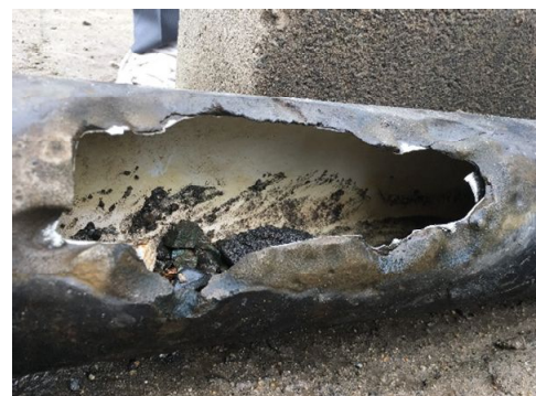
写真2 配水管の老朽化による漏水
