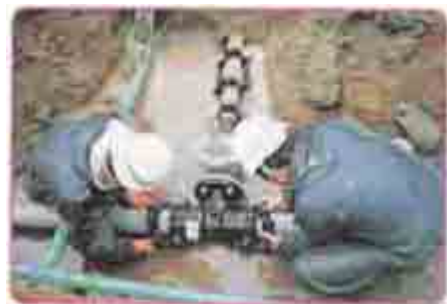
水道管をうめる工事のようす 市の水道の歴史(市水道部資料による)
