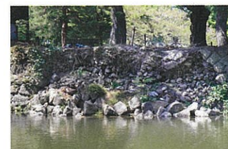
大きく崩れた椿坂東側の堀の石垣
