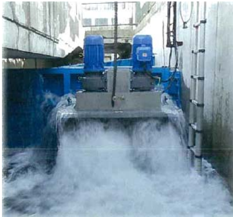
運転状況(例)写真
