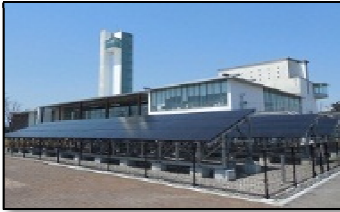
北会津支所の太陽光パネル
