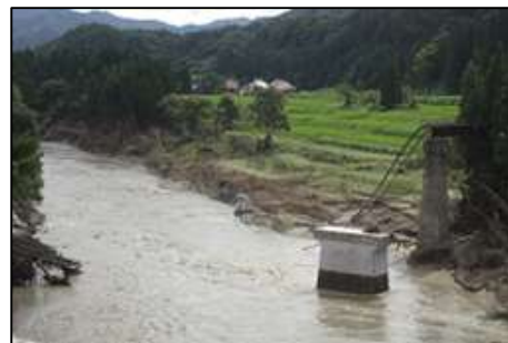
(只見線第7橋梁流出箇所 金山町上横田)
