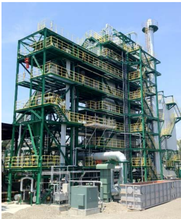
図 5 ㈱グリーン発電会津のバイオマス発電所
