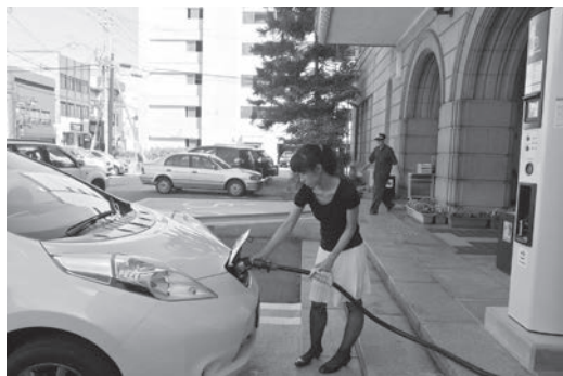
スマートシティの取り組みの一環として本庁舎正面に急速充電器を設置しました
