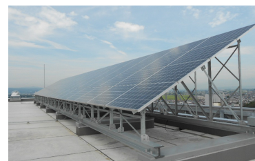
太陽光発電システム（写真は竹田総合病院）
