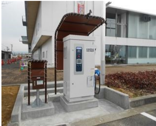
急速充電器(北会津支所)
