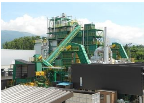
名 称 グリーン発電会津 会津河東発電所 所在地 河東町工業団地 事業者 株式会社グリーン発電会津 設備容量 約5,700kW
