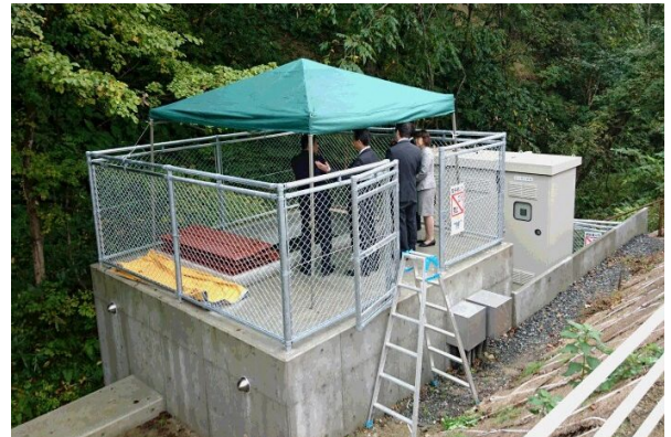
名 称 会津電力戸ノ口堰小水力発電所 所在地 一箕町八幡 事業者 会津電力株式会社 設備容量 31.4kW
