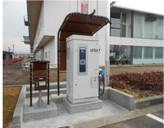
急速充電器（北会津支所）
