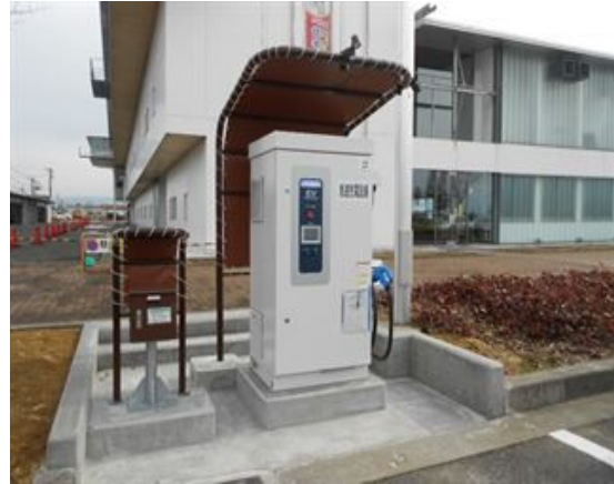
急速充電器（北会津支所）
