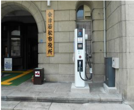
急速充電器（本庁舎）
