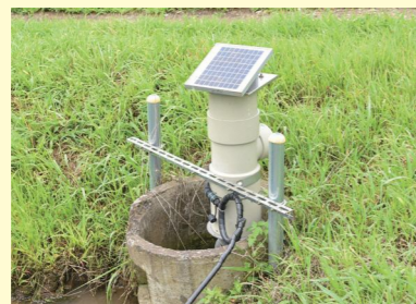
太陽光発電で、給水弁の動力を確保しています
