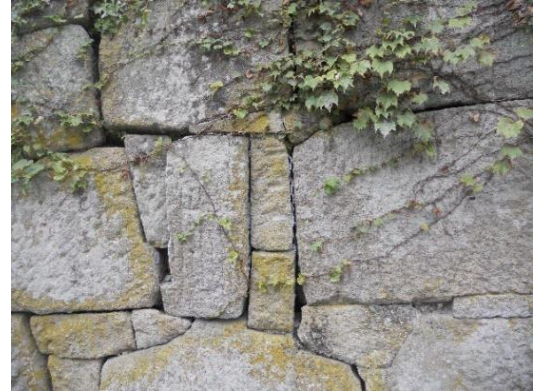
石垣に悪影響を及ぼすツタ等の除去
