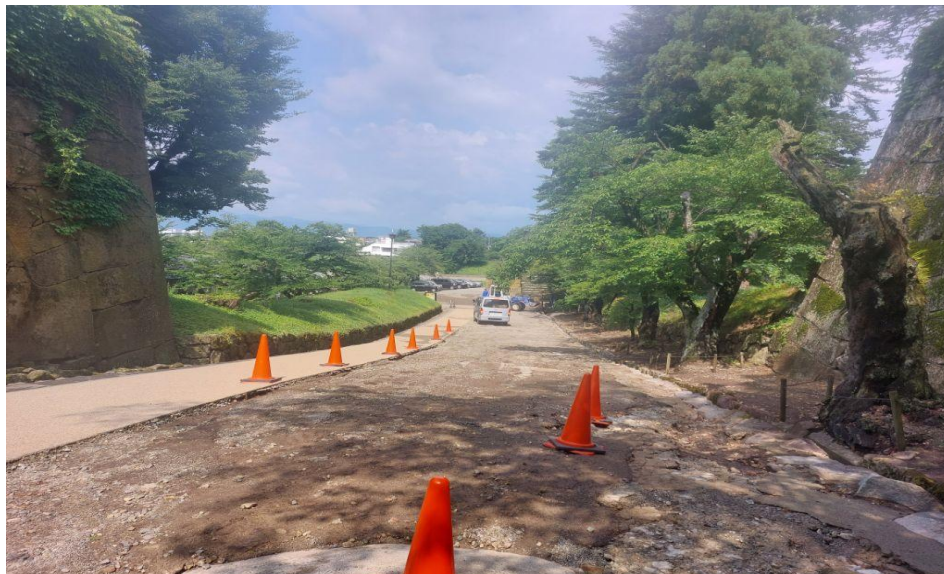
豪雨時における園路の洗堀状況
