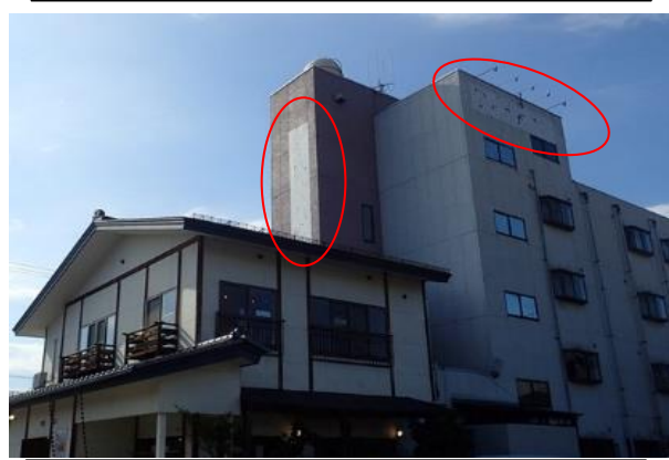
第5種特別規制地域における屋外広告物の是正(10mを超える位置に設置されている壁面広告板の撤去)
