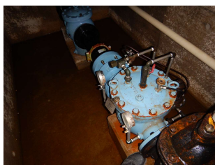
松長ポンプ場定流量弁
