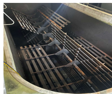
東山浄水場緩速攪拌機
