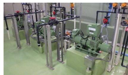
東山浄水場薬注ポンプ
