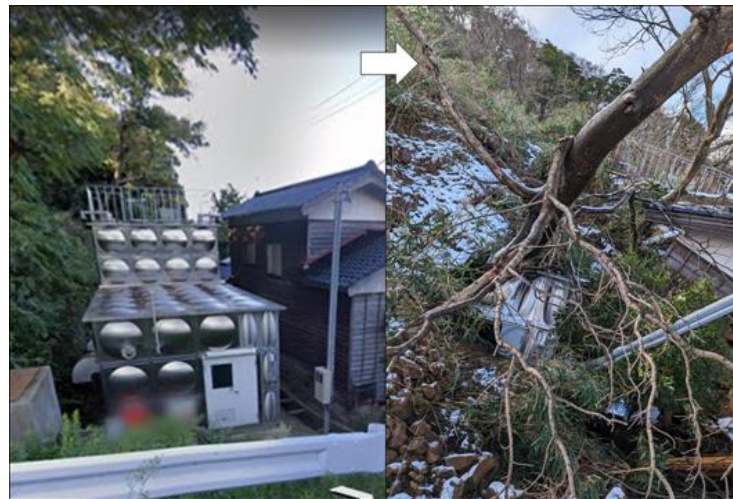
稲船ポンプ所損壊(輪島市)
