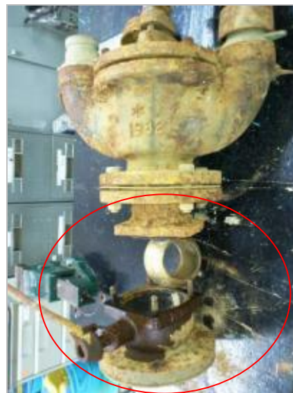
破損箇所 (ボルト腐食)
