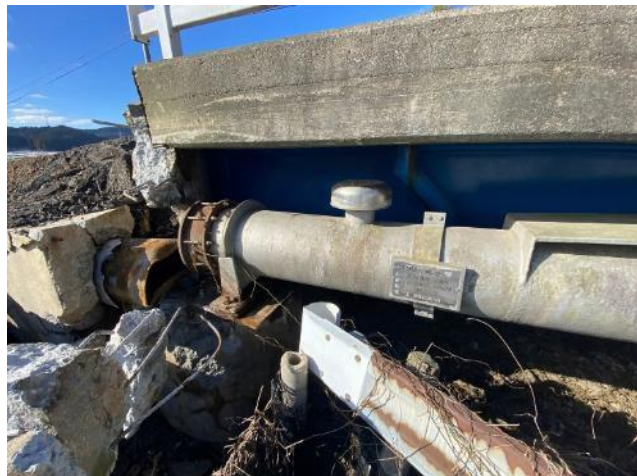
送水管450mm破損(珠洲市)
