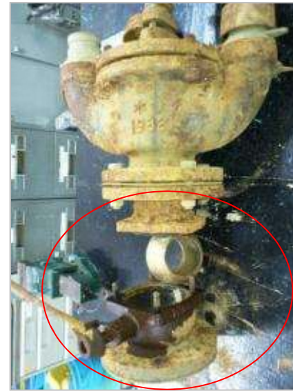
破損箇所 (ボルト腐食)
