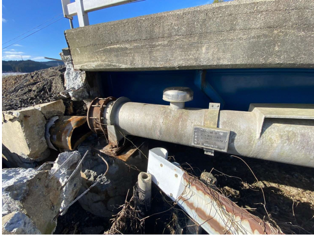
送水管450mm破損(珠洲市)
