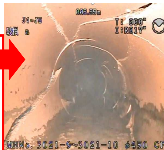
東山温泉街(陶管の縦割れ)
