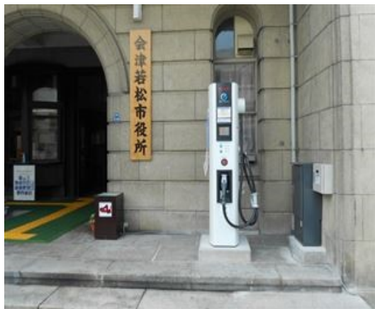
急速充電器（本庁舎）
