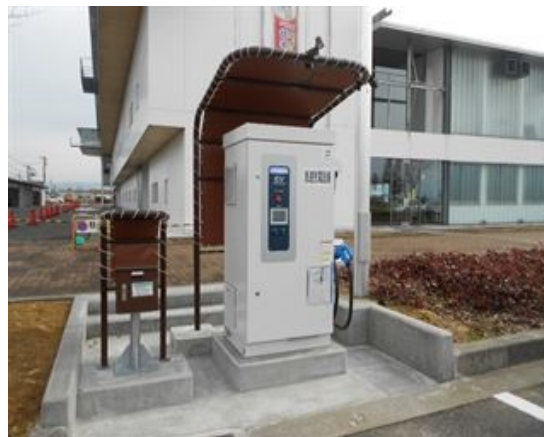
急速充電器（北会津支所）
