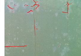
AIによりひび割れの検出例3
