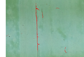
AIによりひび割れの検出例4
