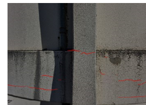
AIによりひび割れの検出例1
