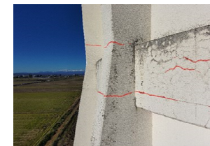
AIによりひび割れの検出例2
