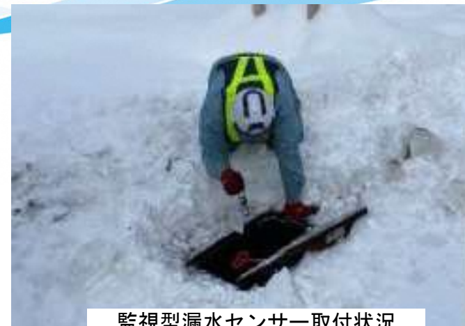
監視型漏水センサー取付状況
