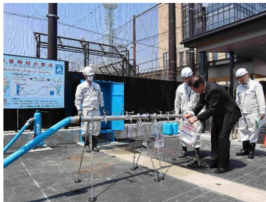
災害時給水栓の整備
