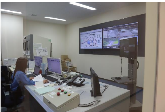
滝沢浄水場の監視システム
