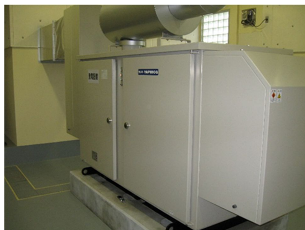
写真8 下雨屋ポンプ場の自家発電設備
