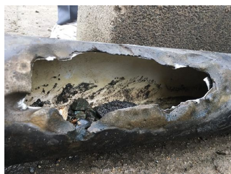
写真2 配水管の老朽化による漏水
