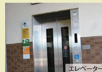
エレベーター
