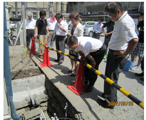
【 雨水浸透枡計測装置設置の様子 】
