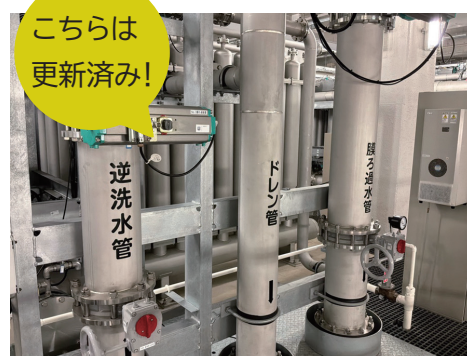
毎日働き続ける水道設備（滝沢浄水場）
