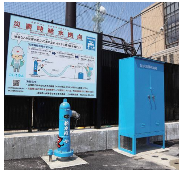
災害時給水拠点（来庁者駐車場内）
