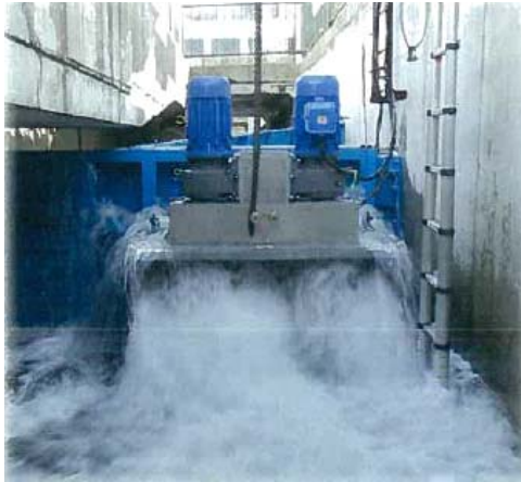
運転状況(例)写真
