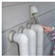
②水道管を保温する管が外気に触れている部分に、電熱ヒーター、保温材を取り付ける。
